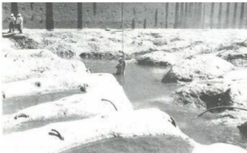
FIGURA 1: Situação da bacia de decantação da usina hidrelétrica Dworshak após a erosão por abrasão hidráulica.
