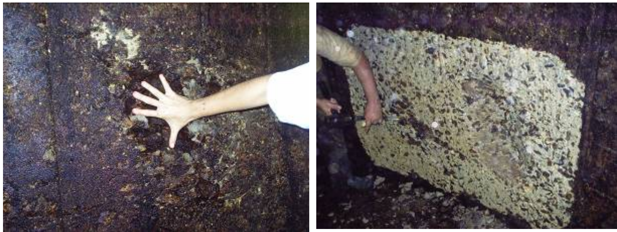
(a) Patologia encontrada na parede de concreto do tubo de sucção da UHE de Curuá-Una; (b) Situação da superfície após a retirada do material segregado.
