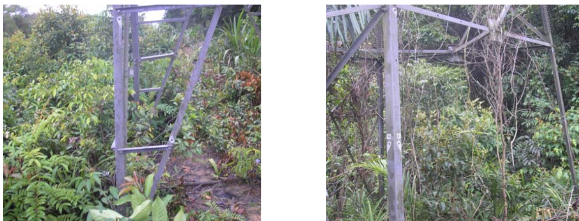
Figura 1 – Fotografias de torres danificadas pela ação de vandalismo. Retiradas de barras de contraventamento dos montantes
