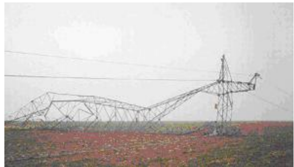
Figura 1 - Torre colapsada, componente da LT de 230 KV Caxipó-Sinop no Estado do Mato Grosso [12].
