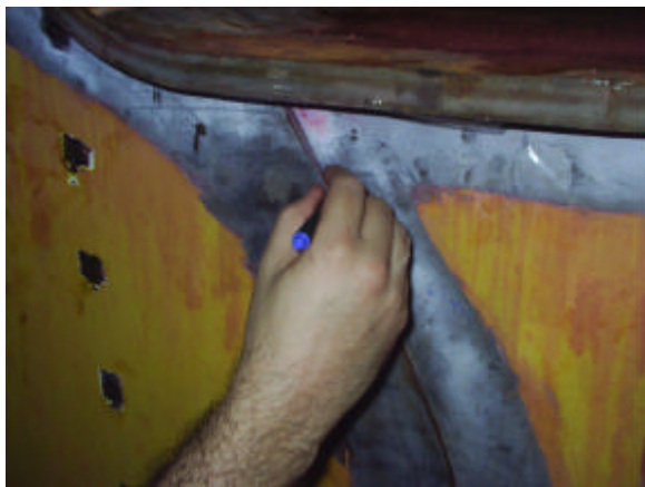
Figura 5 – Mapeamento das trincas para posterior inclusão no modelo pelo MEF
