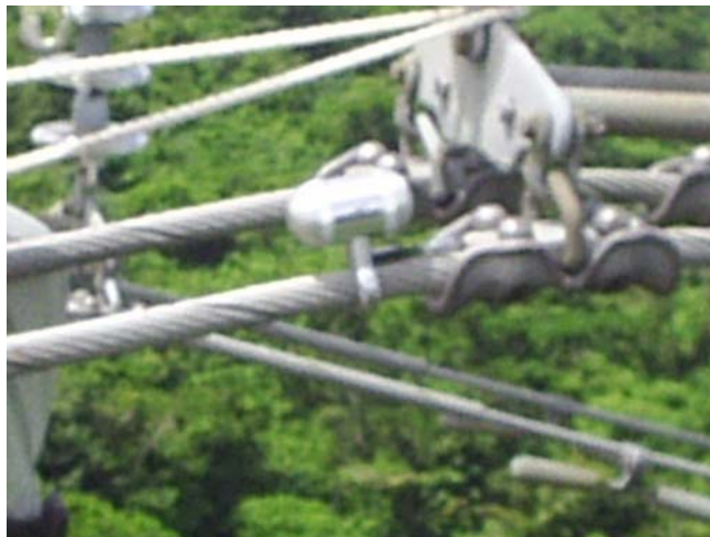
Figura 5 – PAVICA instalado na LT-230 KV, Vila do Conde – Guamá.
